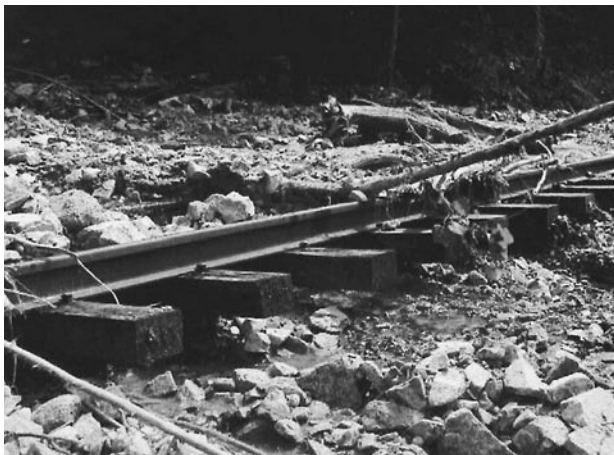
写真-1 軌道へ流出した土石
