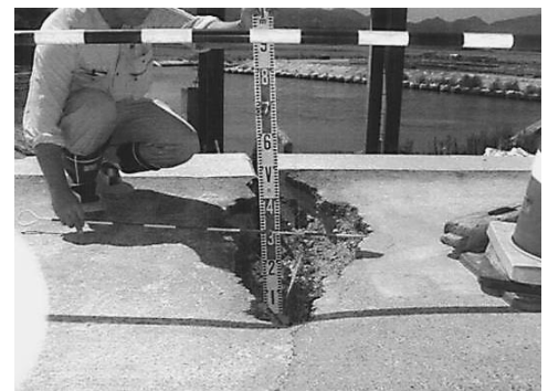
写真-2 高瀬川逆流防止樋門 堤防の陥没状況
