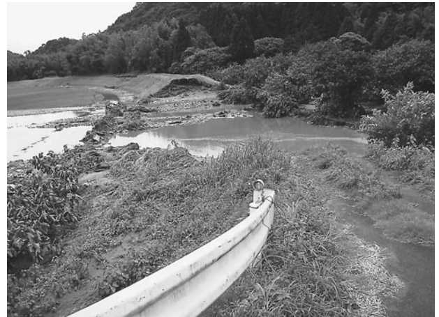
所原町木村地区で3箇所の破堤が発生
