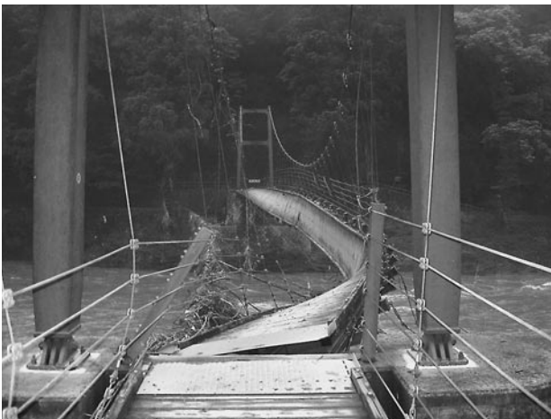
浮嵐橋：被災後
