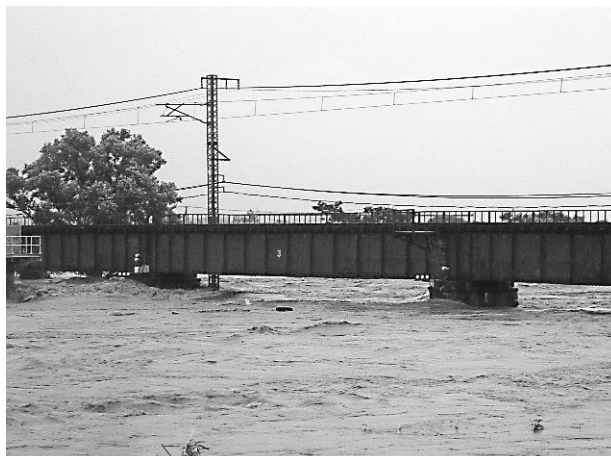
桁下一杯まで水位上昇したJR橋（下古志町）
