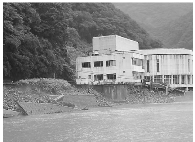
建物の基礎がむき出しになった佐田支所
